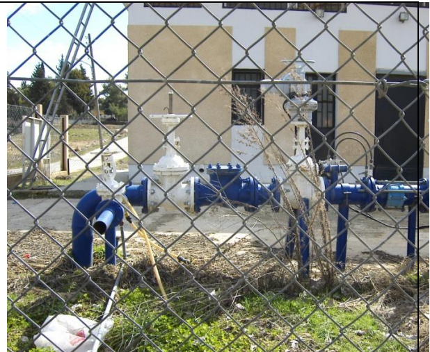
La station de pompage
