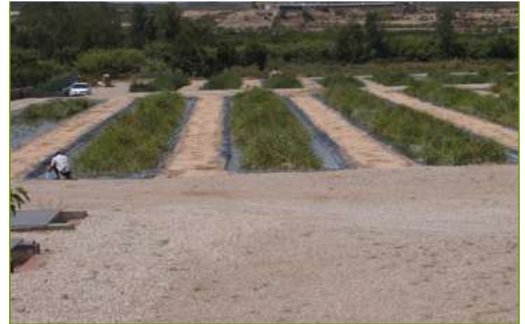
Fabara WWTP (Zaragoza) (FHS)
