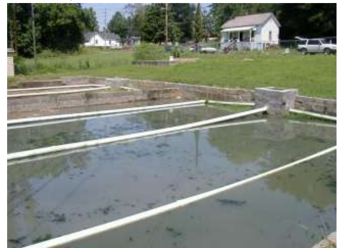
Surcharge dans un filtre à sable intermittent
