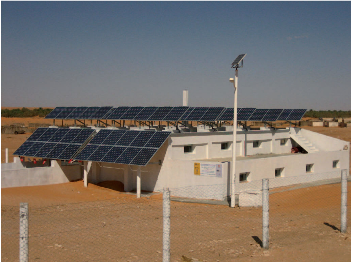
Figure 23 : Une installation PV-OI d'une capacité nominale de 2,1 \text{ m}^3/\text{h} d'eau saumâtre en Tunisie, installée par le Canary Island Institute of Technology, Espagne.
