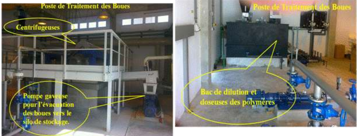
Figure 12. Traitement des boues
