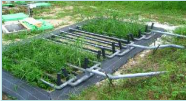
Traitement des eaux usées urbaines- industrielles
