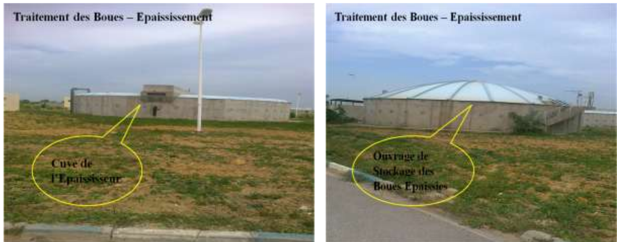
Figure 14. Les ouvrages pour l'épaississement des boues
