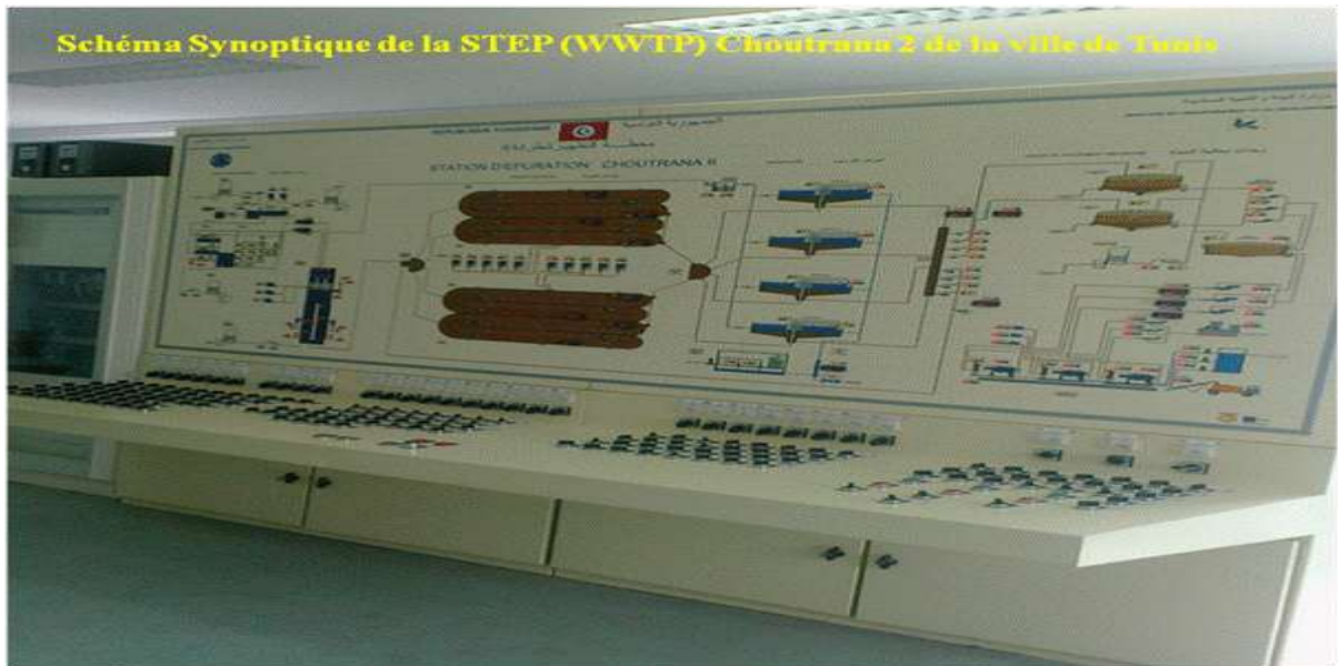
Figure 6. Panneau synoptique de la STEP de Choutrana
