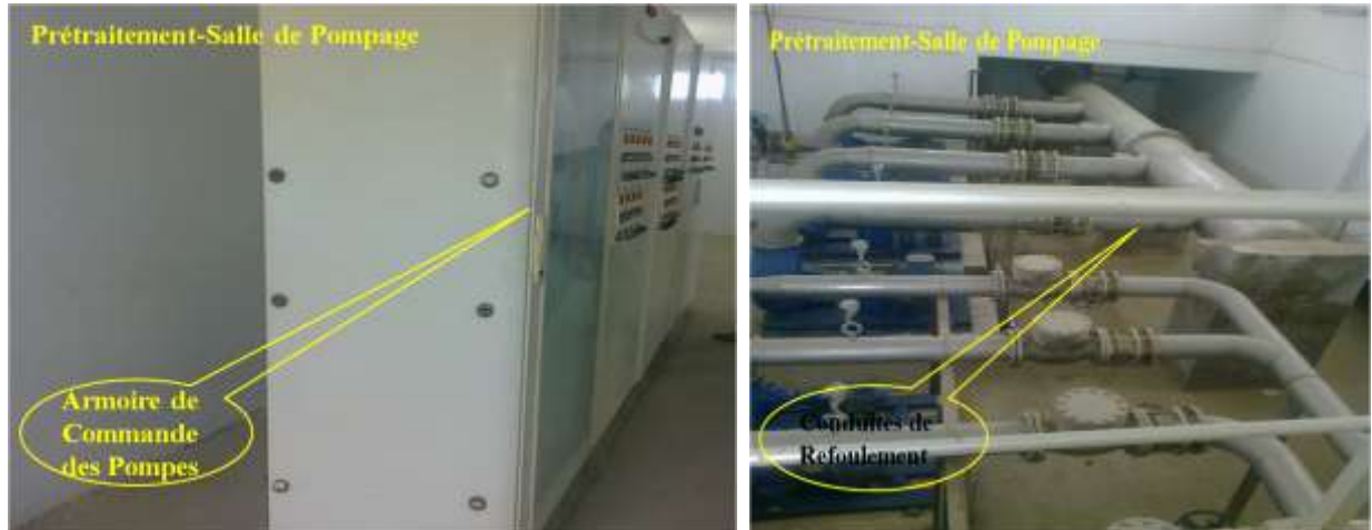
Figure 8. Les stations de pompage
